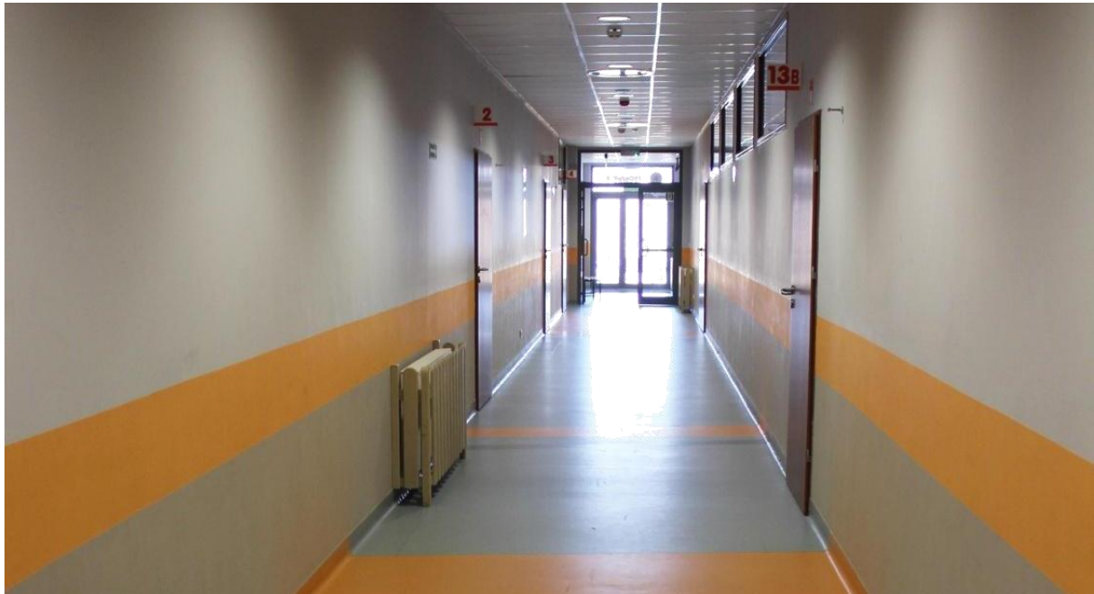
Rysunek 23. Przykład nieprawidłowego sytuowania okien w korytarzach [fot. N. Ratajczak-Szponik].
