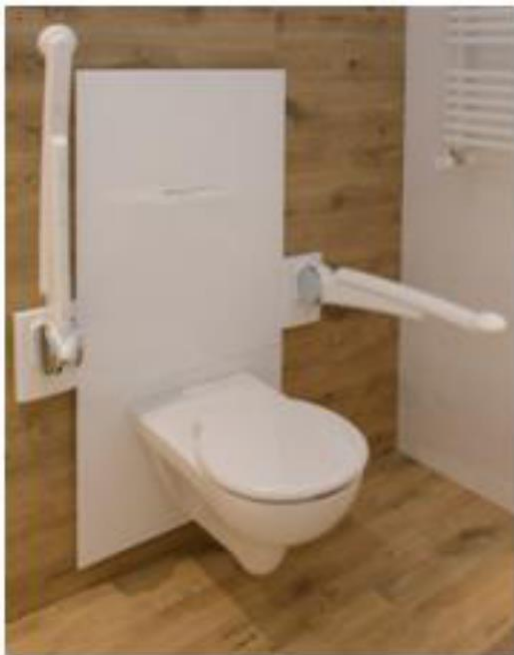
Rysunek 68A. Przykłady urządzeń sanitarnych, w których możliwa jest regulacja poziomu wysokości [fot.: N. Ratajczak-Szponik].
